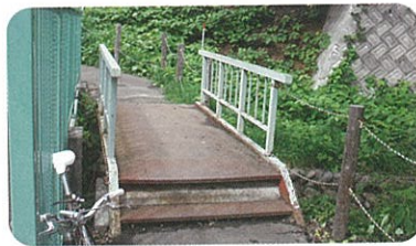
中央区界川1丁目あたりの 老朽化した橋
